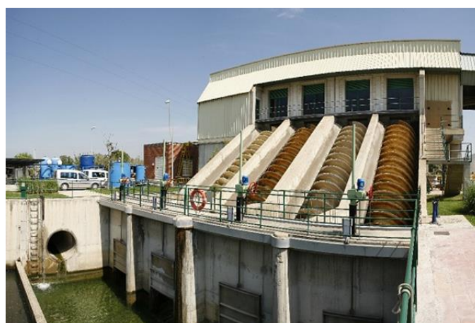
Figura 7.16. Cargols Arquímedes i cambra d'aspiració del bombament intermedi a la ETAP de Sant Joan Despí
